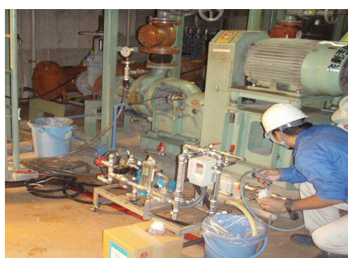
図一2 高分子凝集剤注入簡易設備
